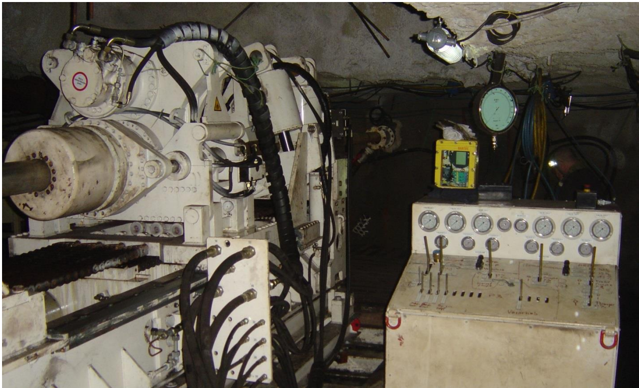
Anlage im Untertage-Einsatz
